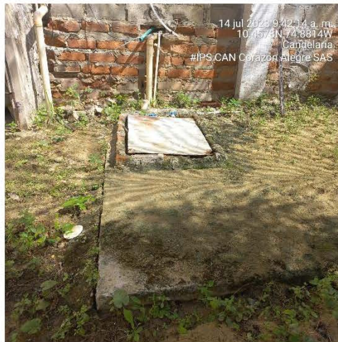
Imagen 3 Ubicación de la poza séptica donde vierten las aguas residuales IPS Corazón Alegre SAS del Municipio de Candelaria Coordenada N° 10 4578 y W° 74°881
